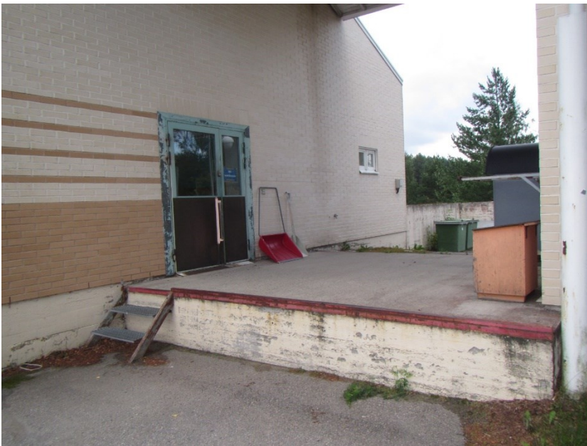
KUVA 7: Lajittelutilaan liittyvä lastaussilta. Mikäli lastaussilta ei ole käytössä, suositellaan sille kaiteen asentamista.
